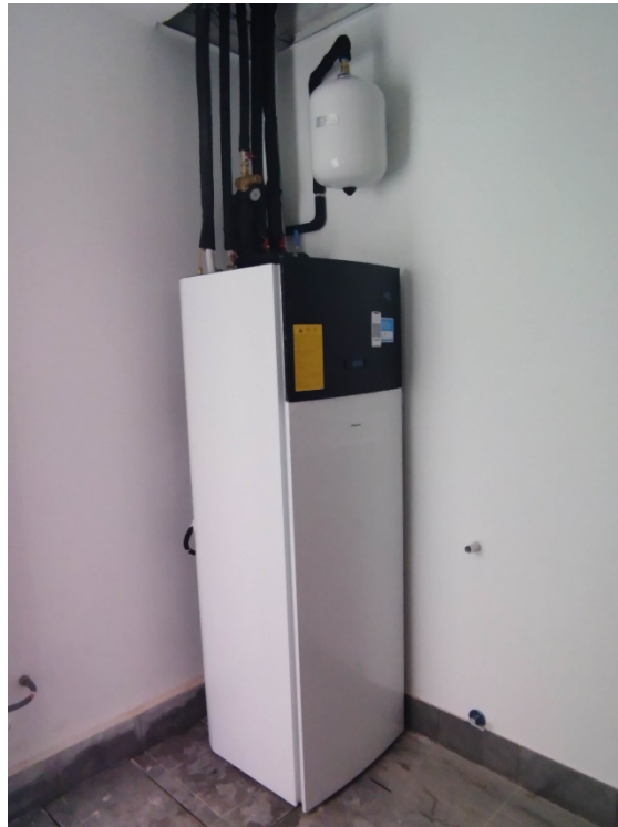
Unidad interior en garaje
