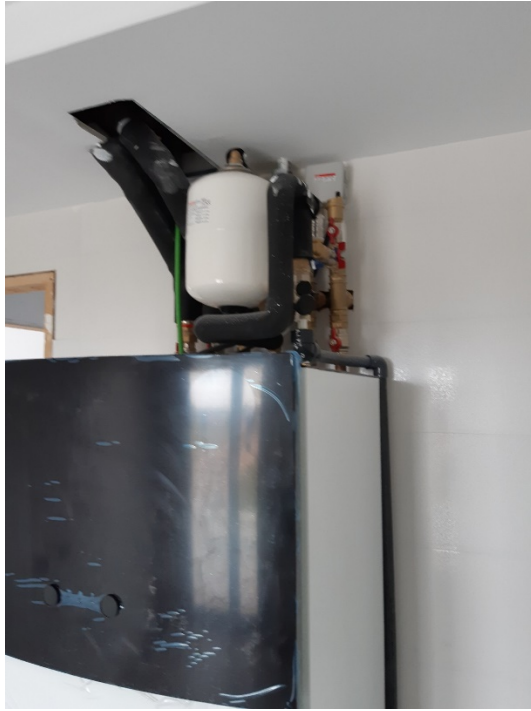
Detalle de unidad interior
