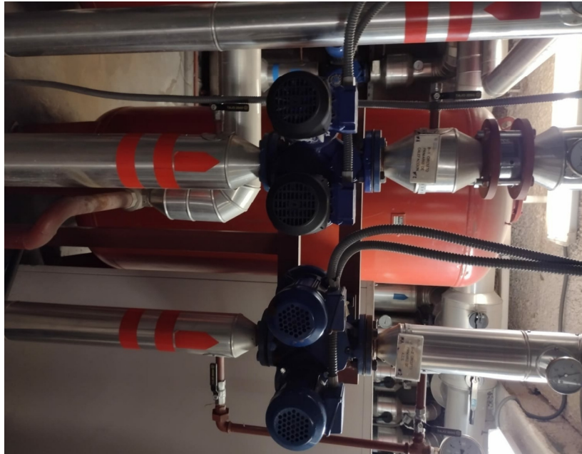
BOMBAS PRIMARIO CALEFACCIÓN
